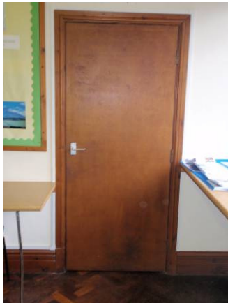
Door 14 Link Door
